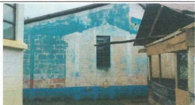
Foto 3: Se observa en la fotografía el deterioro de la pared del aula del módulo uno
