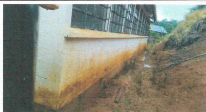
Foto 2: Se observa en la fotografía el deterioro de la pared del aula del módulo dos.
