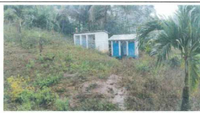
Foto 4: Se observa en la fotografía el deterioro de la puerta y la pared del baño.
