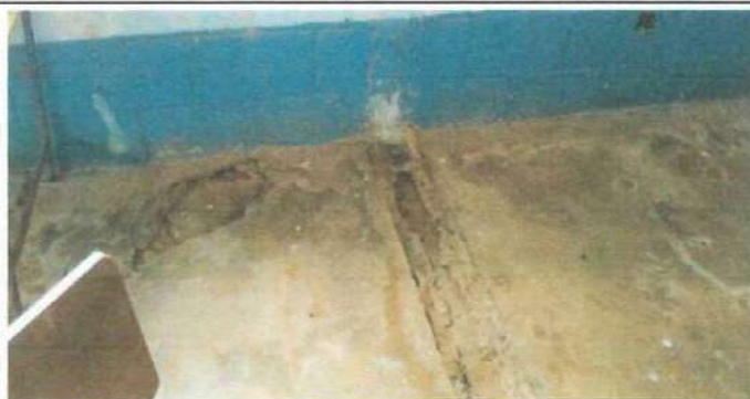
Foto1: Se observa en la fotografía el deterioro del piso del aula uno.
