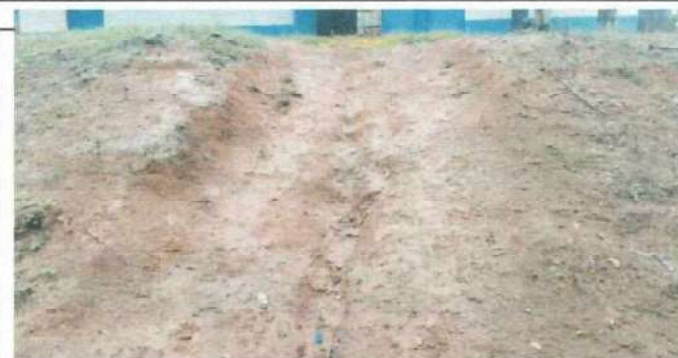
Foto 5: Se observa en la fotografía el riesgo de accidente involuntario de los niños en la entrada de la escuela.
